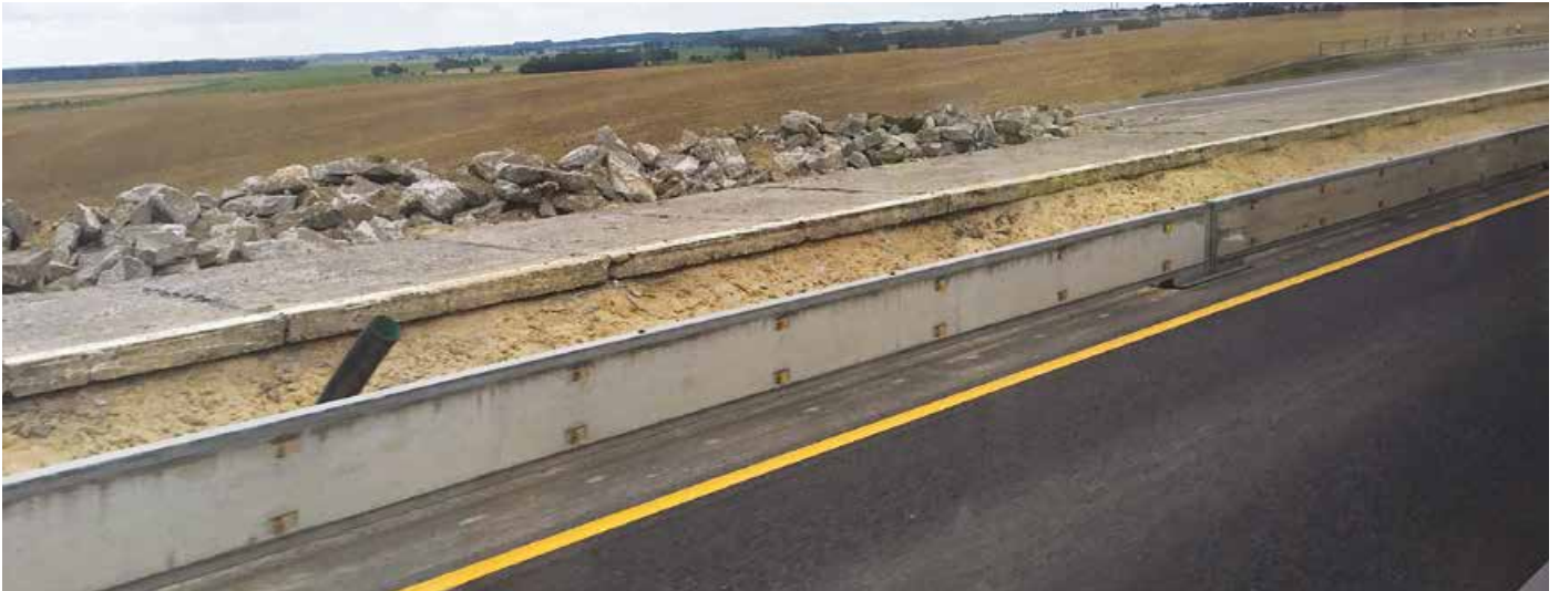
Een typisch voorbeeld van een betonnen wegdek dat vanwege loslating wordt gesloopt, een probleem dat eenvoudig met TRACK PILE™ kan worden opgelost.
